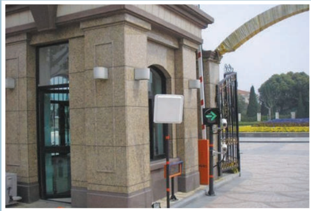
智能停车场管理 RFID Parking System
